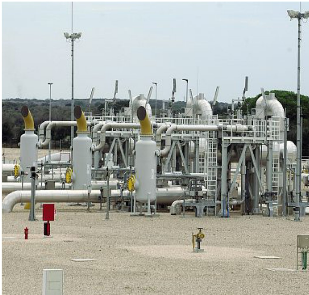
L'impianto di San Foca a Melendugno. Il Tap (Trans Adriatic Pipeline) è un gasdotto che permette all'Italia di importare il gas naturale estratto in Azerbaijan. Lungo circa 878 km, viaggia dalla Grecia fino alla Puglia
