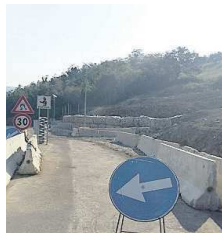
STATALE 87 Il fronte della frana
