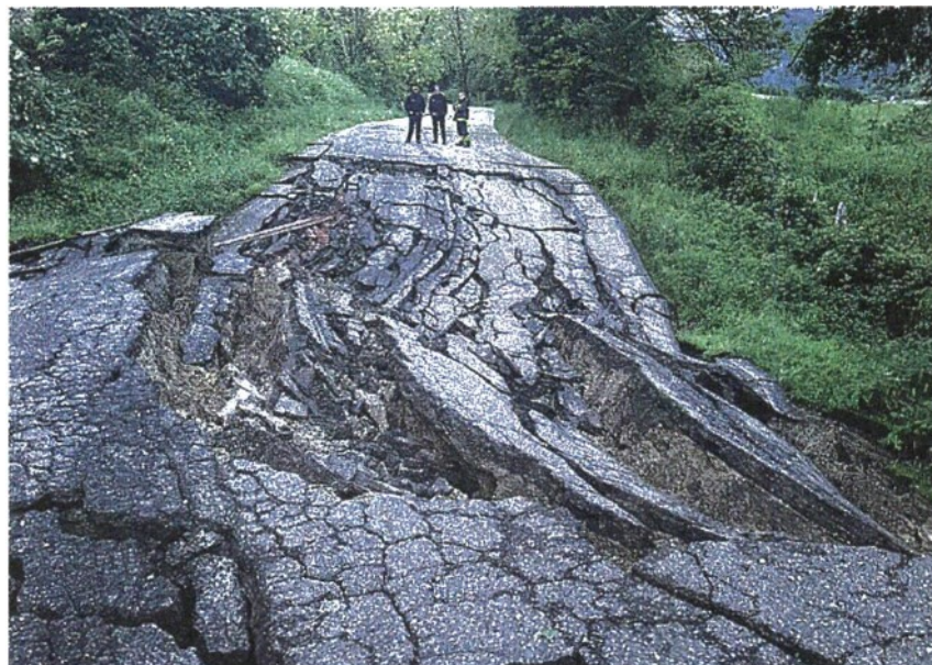
Sopralluogo Controlli su una strada dissestata dopo una frana a Bagno di Romagna (Ansa)
